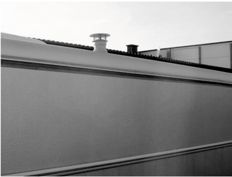
Fig. 89: Conduit d'évacuation des gaz brûlés du chauffage à gaz
